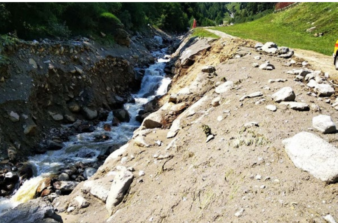
Effetti del passaggio della colata detritica avvenuta il 31 luglio 2020 sul rio Taviela (Pejo).
